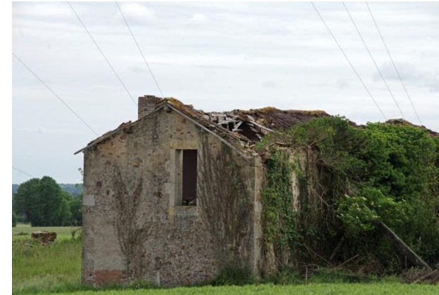
Photo 3 : bâtiment en ruine de la Naulerie, côté sud-ouest
