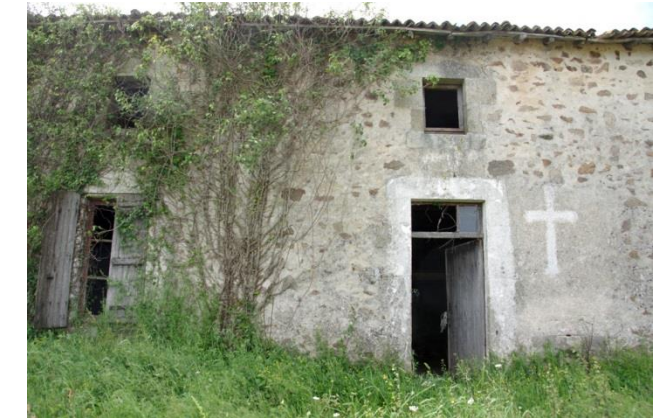
Photo 4 : bâtiment en ruine de la Naulerie, côté nord
